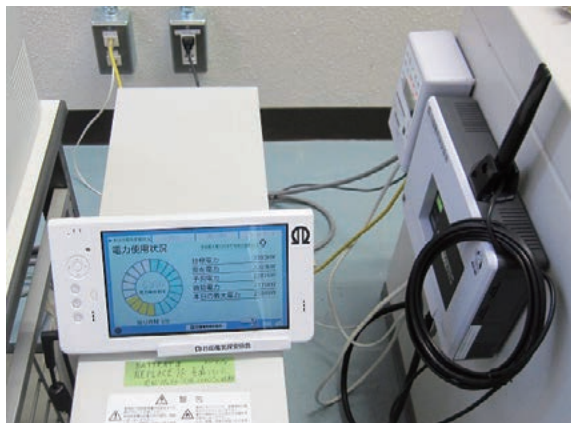
デマンド監視装置
