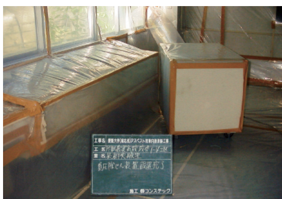
負圧除じん装置設置状況
